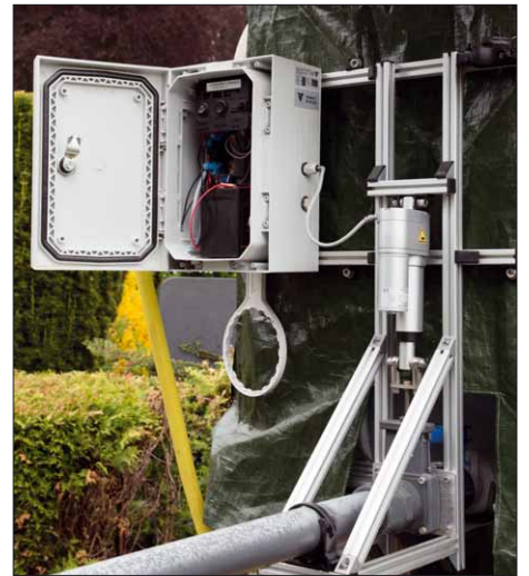
Technik der Tankstation
